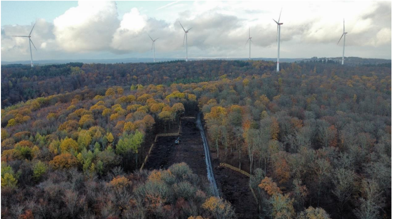
Abbildung: An dieser Stelle entsteht eine der beiden Windkraftanlagen im Windpark Blasbach. / Bildrechte: Koehler-Gruppe
